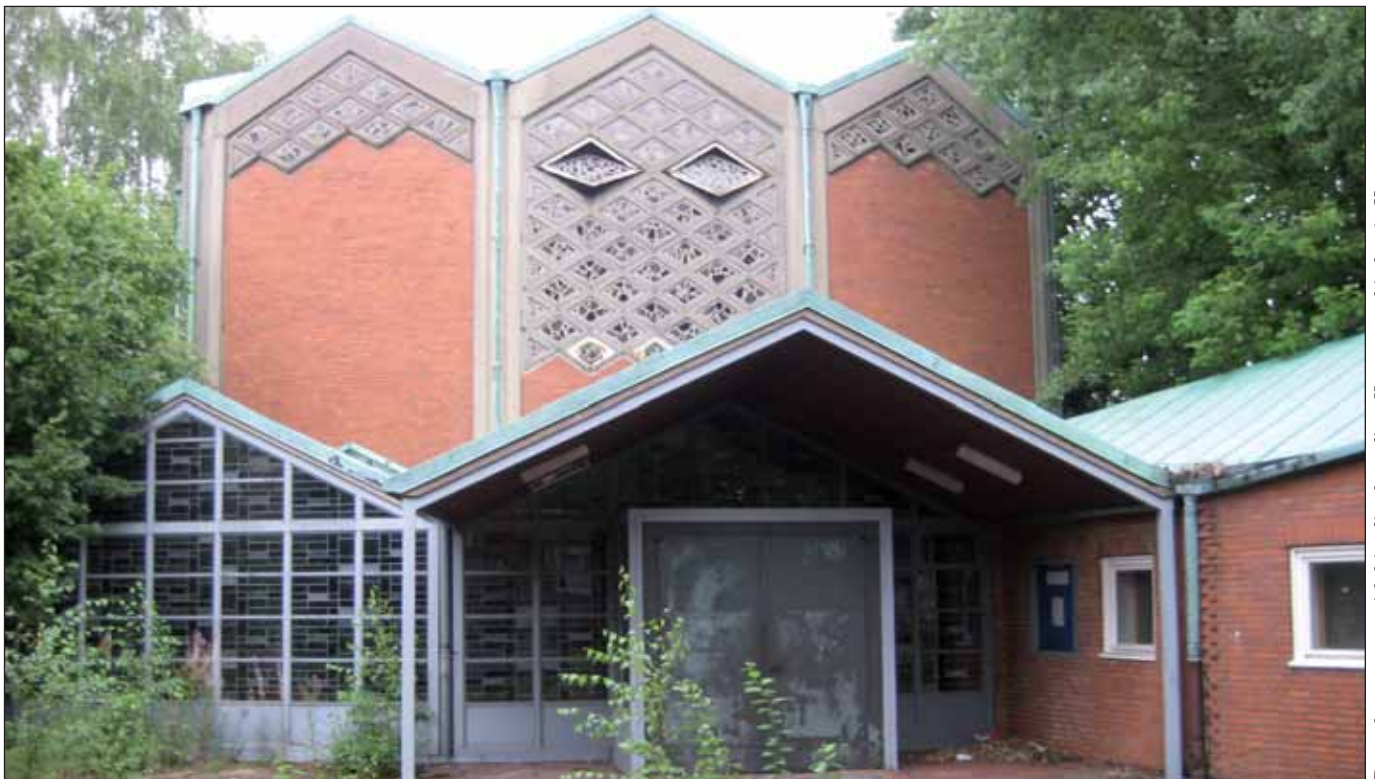
Rottet langsam vor sich hin: die ehemalige »Kapernaumkirche« in Horn
